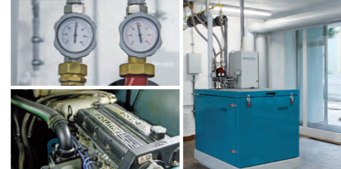
BHKW-Anlage in der Eythstraße im Lindenhof
