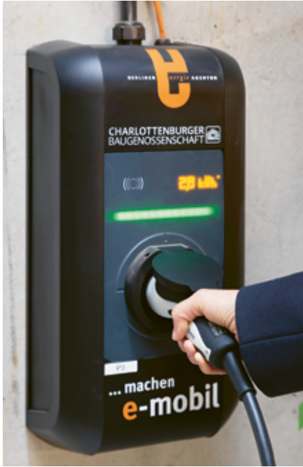
Beispiel einer Ladestation bei der Charlottenburger Baugenossenschaft
